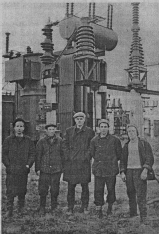
110 После замены трансформатора мощностью 5,6 мГвА на 15 мГвА напряжением 110/35/6 кВ на подстанции «Шумерлинская».
