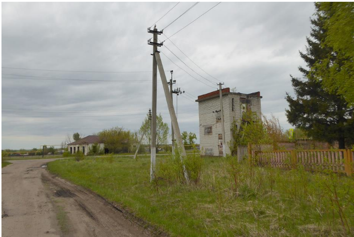
Фото 5 Трансформаторная подстанция у северо-западного угла парка им. М. Сеспеля. Вид с ул. Сеспеля
